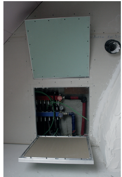
De verdeler van de vloerverwarming op een van de verdiepingen.
