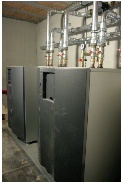
Er werd geopteerd voor een cascade-opstelling van twee 17 kW bodem-water warmtepompen Alpha Innotec van Nathan.
